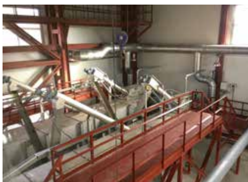
Узел механической очистки и обезвоживания осадков
