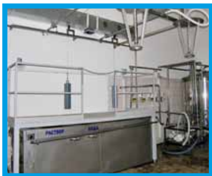
Фото 3. Бак повторноиспользуемой отопленной воды для ополаскивания автомолцистерн
