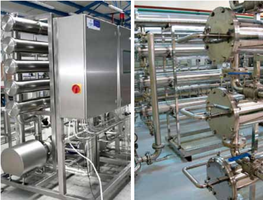
■ Оборудование для ультрафильтрации
