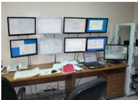
Мониторинг и видеоконтроль
