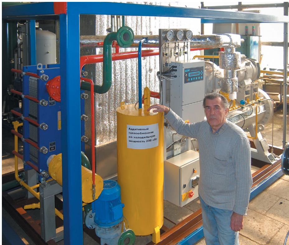
Фото 2. Моноблочный чиллер холодильной мощностью 200 кВт.
