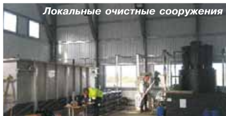
Локальные очистные сооружения
